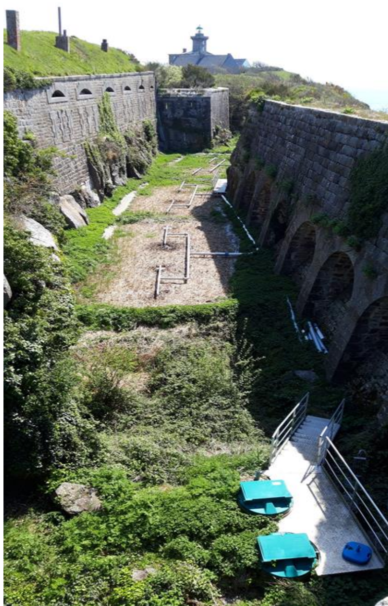
Station de traitement des eaux usées de l'île de Chausey – le Fort
