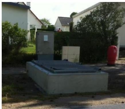
Figure 54 : Poste de refoulement du Sud réhabilité (Cliché CD50, juin 2016).
